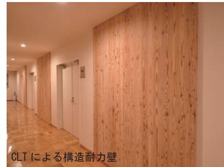
CLTによる構造耐力壁
