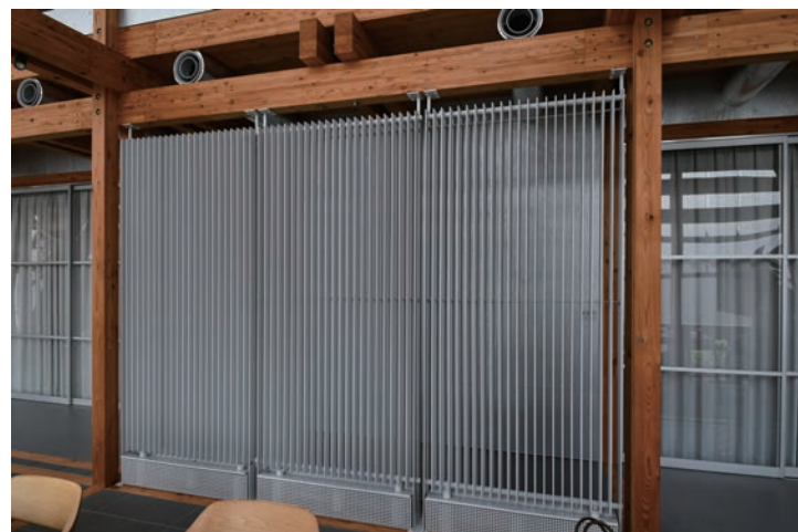
輻射式暖冷房システム
