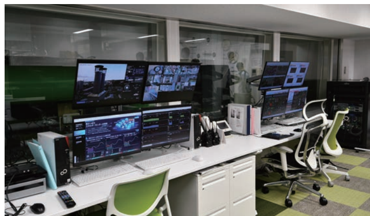
エネルギーセンター中央監視室
